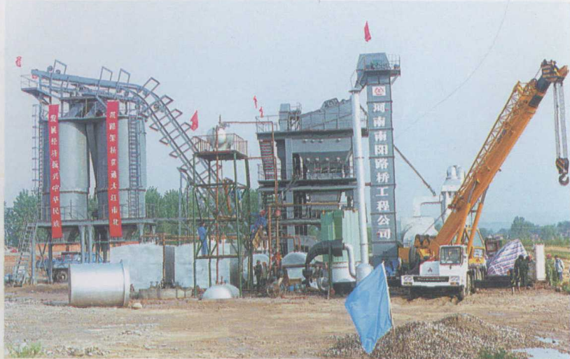
工程处拥有的沥青混凝土拌和楼
