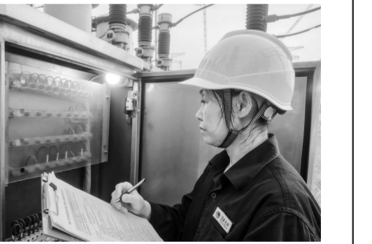
运维人员对500千伏济源变电站开展特殊巡视。
