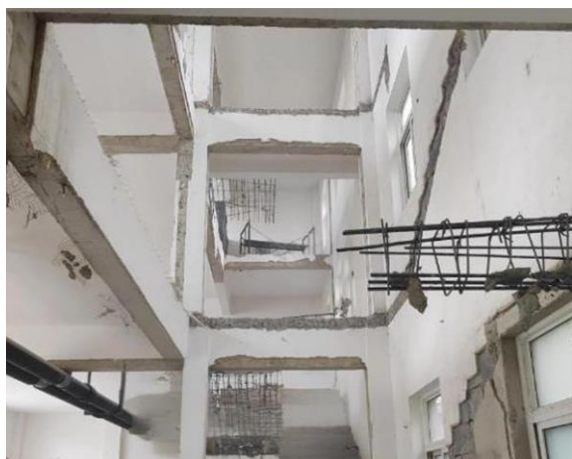
图 5.1.6-1 擅自拆除楼板
