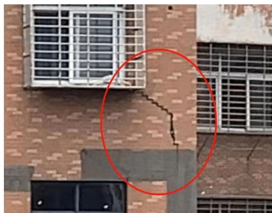
图 9.1.2-2 地基不均匀沉降裂缝
