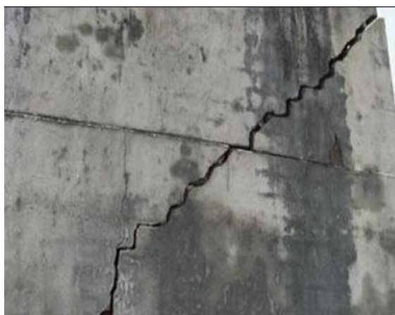
图 9.1.2-1 地基不均匀沉降裂缝
