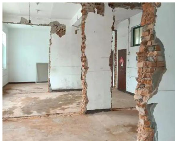
图 5.1.6-2 擅自拆除承重墙
