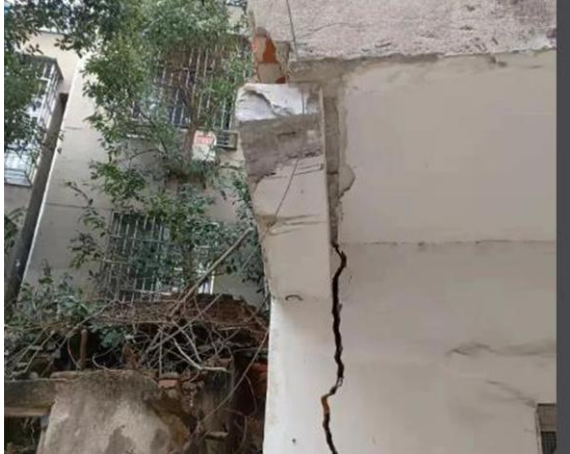
图 5.3.5-1 自建房承重墙体开裂
