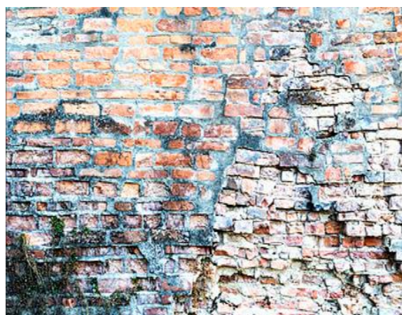
图 9.1.2-3 砌体风化剥落
