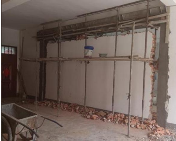
图 5.3.4-1 擅自承重墙体改梁
