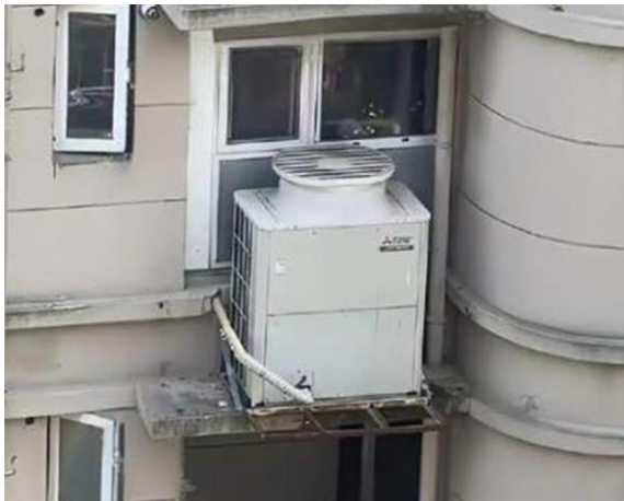
图 5.1.2-1 悬挑板搁置大型空调主机
