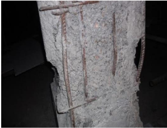
图 9.1.2-5 柱轴心受压损伤
