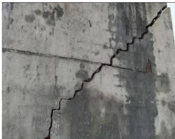
图 9.1.2-1 地基不均匀沉降裂缝
