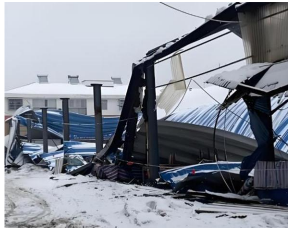
图 5.2.10-2 屋面积雪致仓库垮塌
