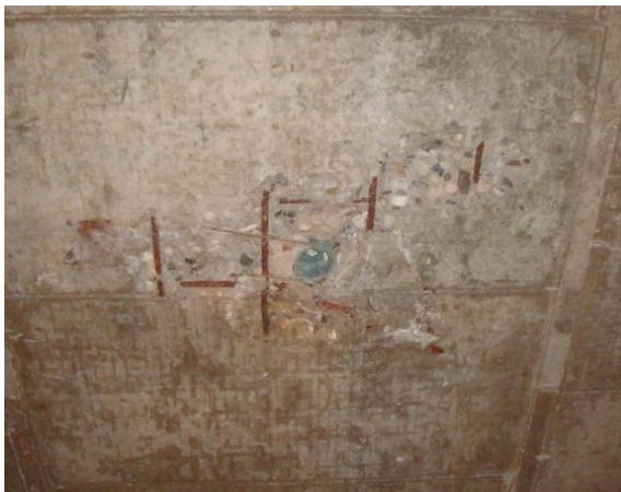
图 9.1.2-7 混凝土酥裂、钢筋外露锈蚀
