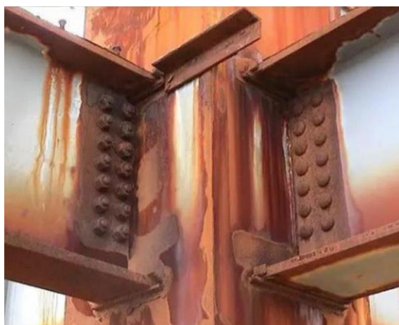
图 5.1.22-2 钢结构节点锈蚀
