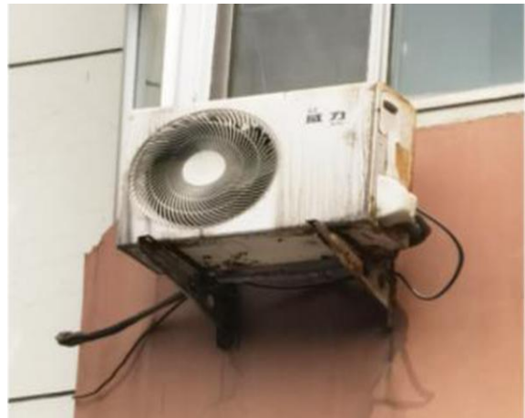
图 5.1.2-2 阳台女儿墙安装空调主机
